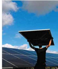
Instalação de painel solar em parque fotovoltaico em Erfstadt, Alemanha. Ina Fassbender - 22.out.24/AFP
